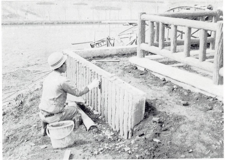
墳頂部通路L型コンクリート 外面擬木処理 (昭和59年度)
